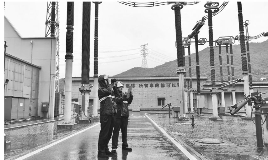
运维人员对电力设备进行红外测温 and 巡检。
