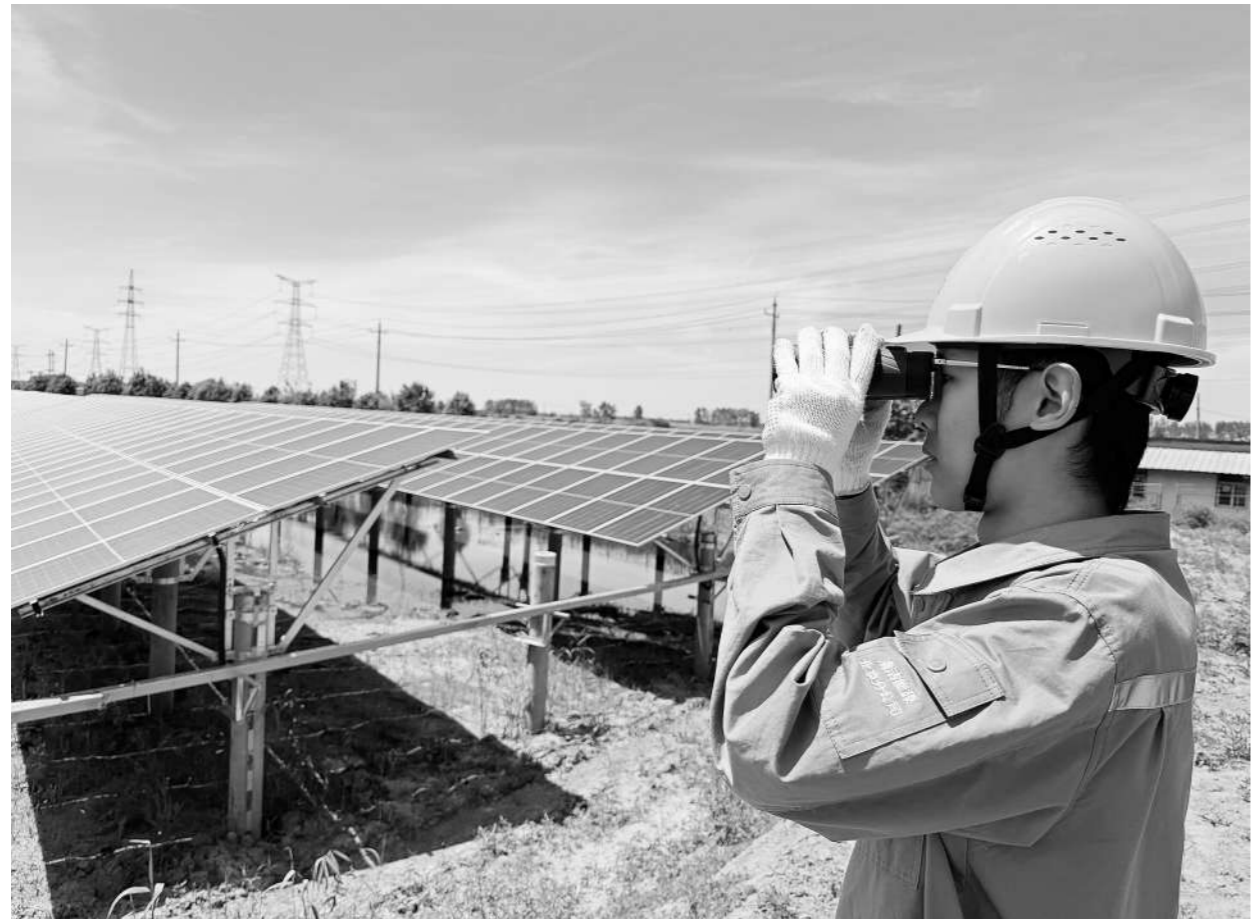
检修员在光伏电站巡查光伏板运行状态。
