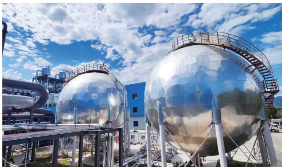
金隅冀东水泥窑协同处置二氧化碳捕集利用示范线。
