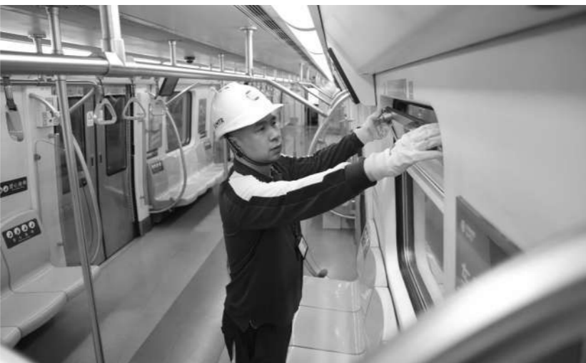
车辆维修人员正对一列电客车进行检查。
