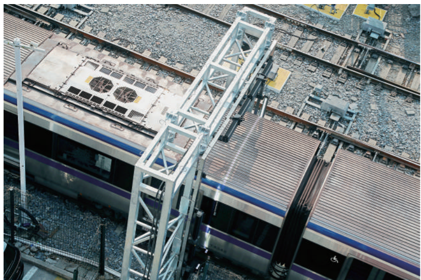
龙门架采集系统发射光束对回库列车进行360度探伤扫描。 ■记者 周宇杰/摄
