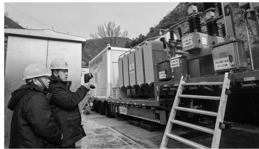
工作人员正巡检供电设备。
