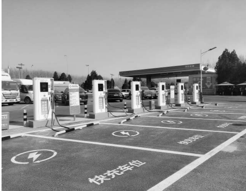
高速公路服务区实现充电设施全覆盖。
