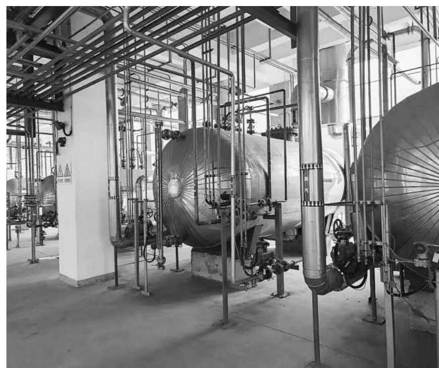
化工厂推进进口药剂国产化替代研发项目。
