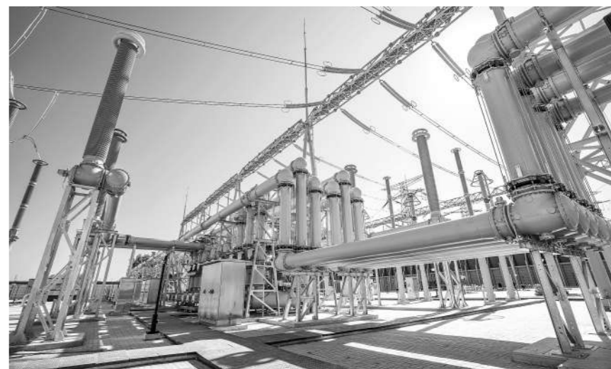
国网北京电力亦庄500千伏变电站设备。
