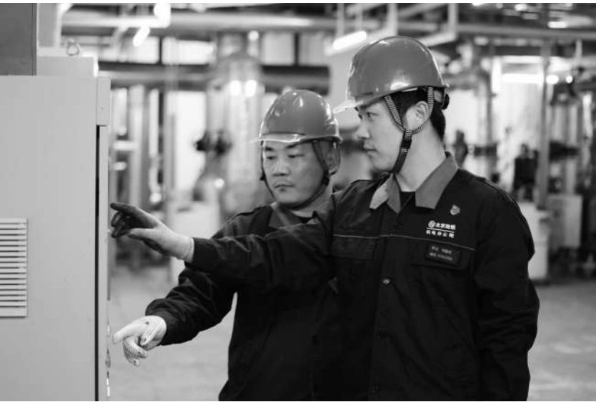
工作人员正对冷水系统管路进行检查维护
